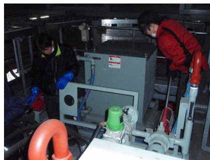
ゴンドラ予備原動機操作方法訓練
