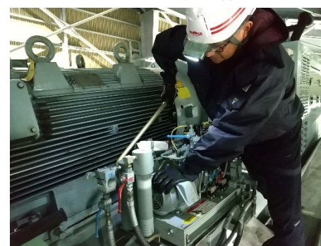
ゴンドラ予備原動機操作方法訓練
